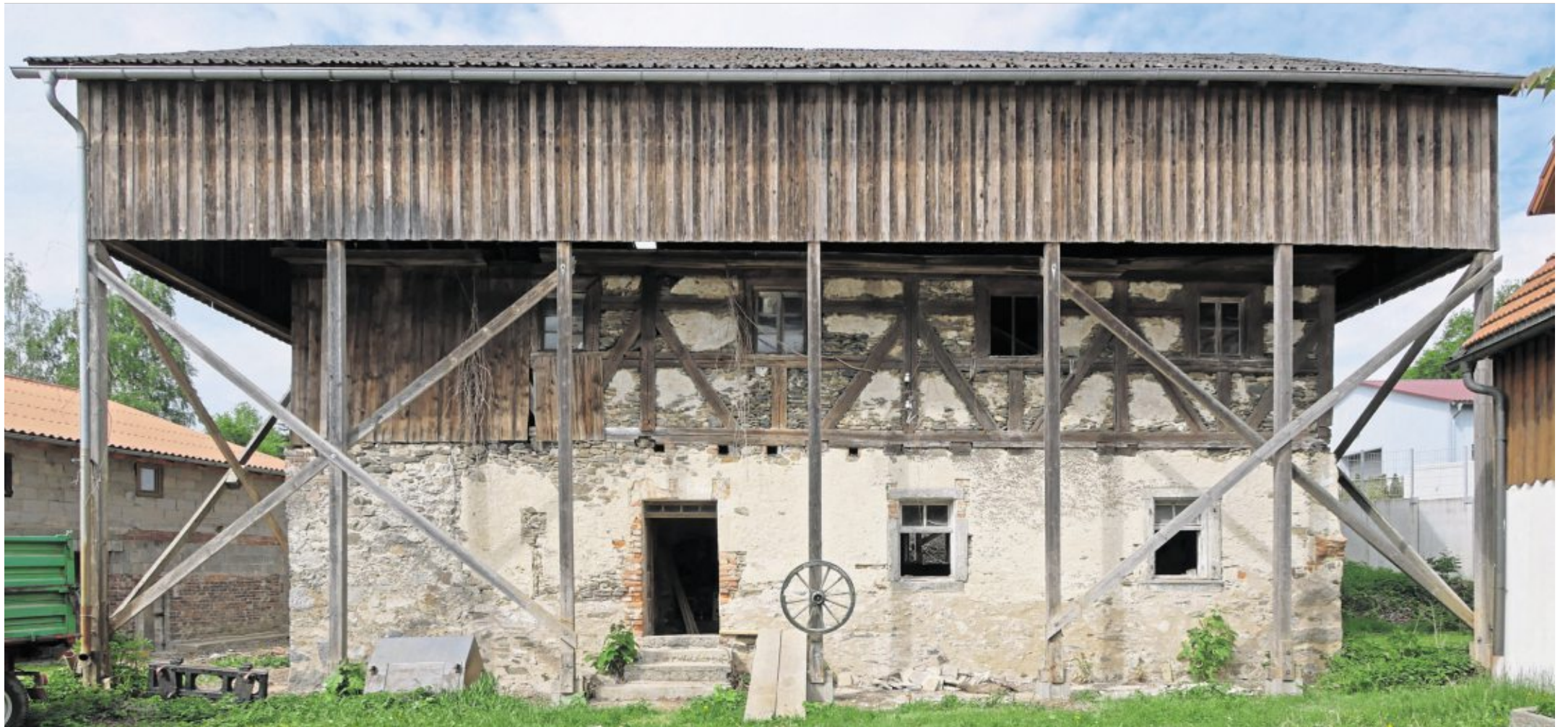
So präsentiert sich die Mühle aktuell. Nach der Sanierung könnte sich das Fachwerk zu einem wahren Blickfang entwickeln.
